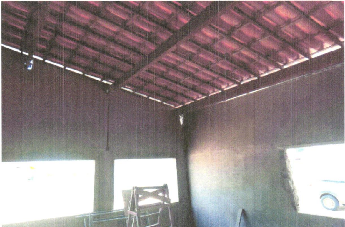
FOTO 9 - Retelhamento em cobertura com telha ceramica tipo canal comum, Itabaiana ou similar
